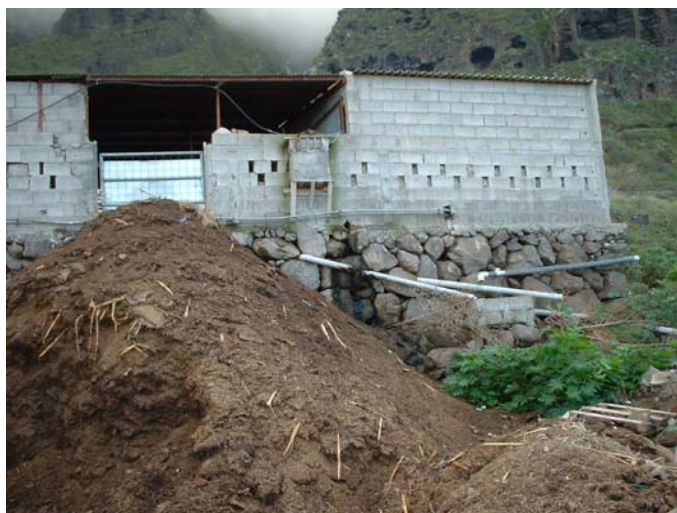
Acabado de la construcción deficiente
