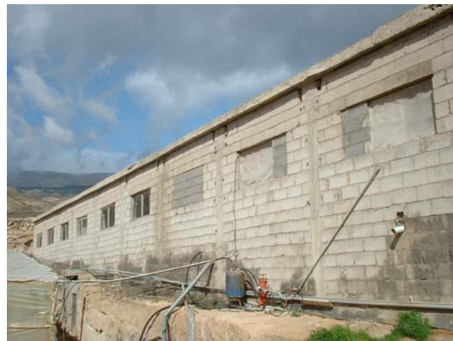
Explotación que carece de la superficie mínima de parcela establecida en la normativa municipal
