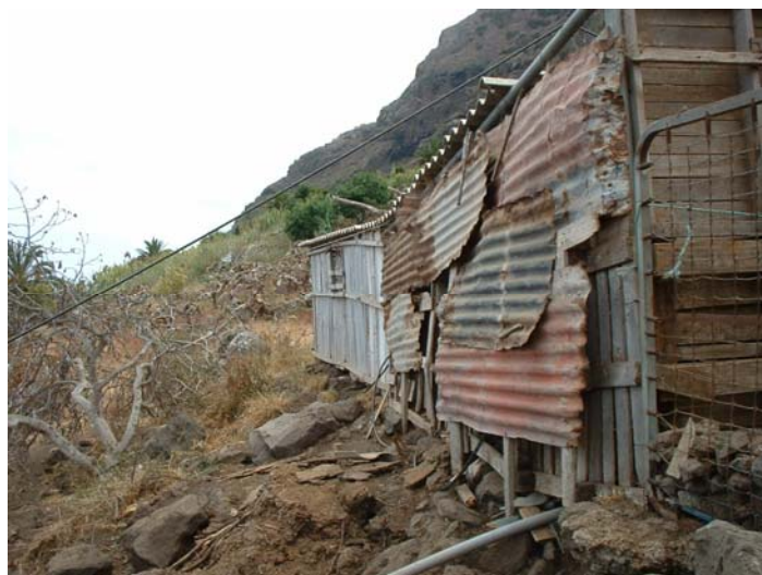
Acabado inapropiado de corrales para animales
