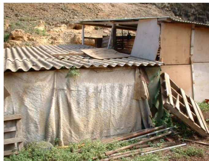
Acabado inapropiado de corrales para animales
