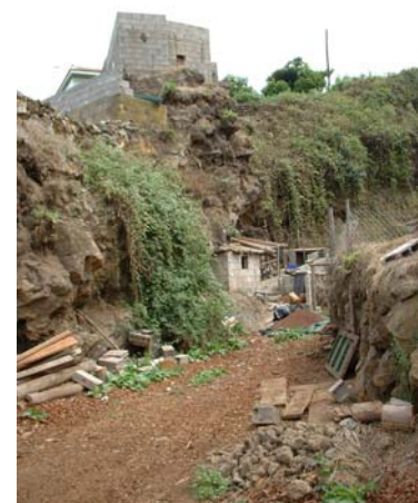
Foto 4: Construcciones y cerramientos en interior de cauce
