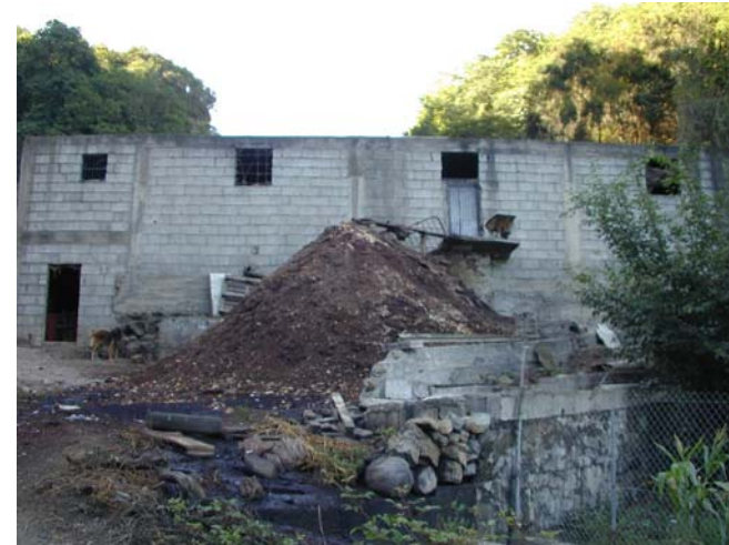
Foto 10: Falta de acabado en fachada principal
