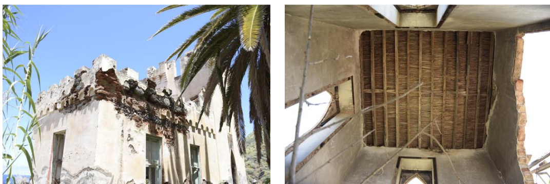
Figura 19: Estado actual del Castillete de la Finca Domínguez
