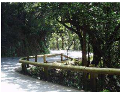
Barrera de seguridad forrada en madera en ámbito natural. La elección de acabados y elementos singulares con materiales naturales (piedra, madera, etc.) confiere personalidad y carácter de naturaleza que se pretenda a la carretera.
