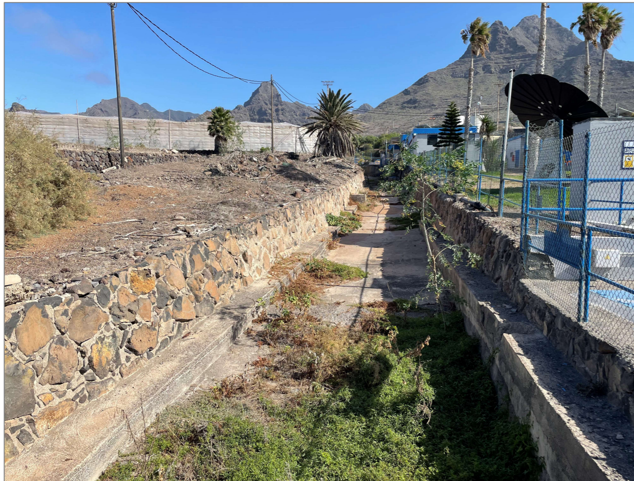
Figura 41 Detalle de la canalización del barranquillo Perera a su paso junto a la EDAR de Punta del Hidalgo
