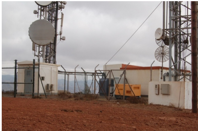
Foto N° 16: Escaso tratamiento de integración paisajística de casetas. Montaña Talavera (El Rosario)
