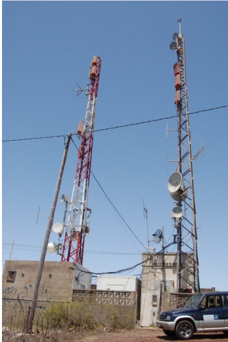
Foto N° 36: Cerramiento abierto en San Roque
