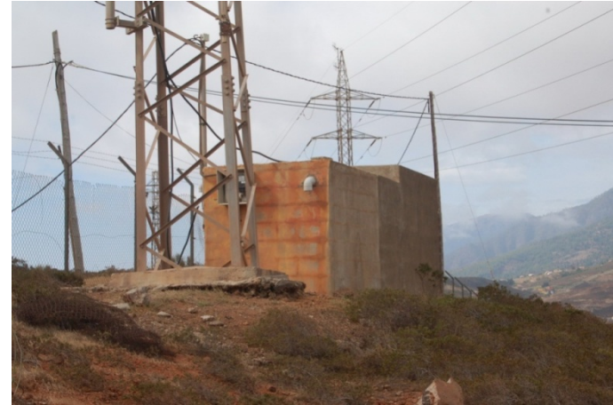
Foto N° 35: Ausencia de cerramiento en Montaña Talavera
