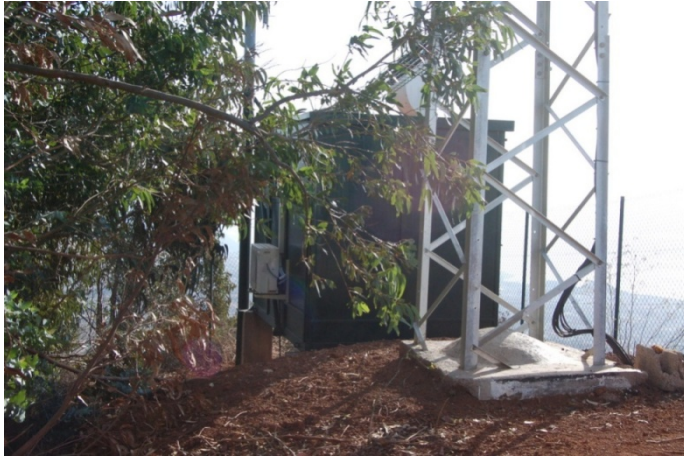
Foto N° 34: Ausencia de cerramiento en Montaña Birmagen
