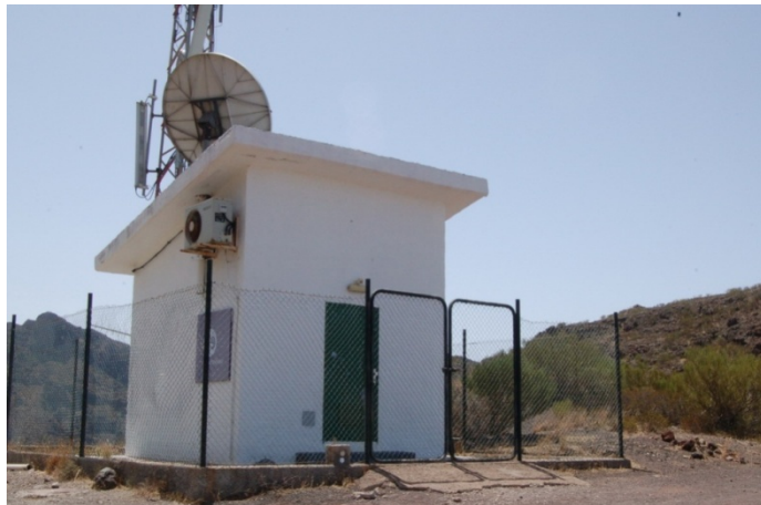
Foto Nº 12: Escaso tratamiento de integración paisajística de caseta. Masca
