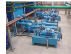
Edificio de deshidratación mecánica
