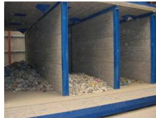
Foto 14. Zona de almacenamiento de envases ligeros clasificados.
