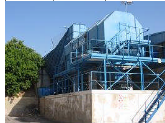
Foto 6. Vista del tromel de entrada a la planta de compostaje (10 cm de paso).
