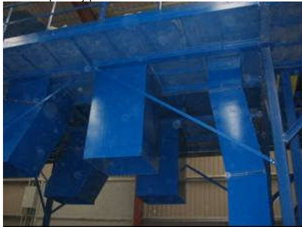
Foto 12. Zona clasificadora de voluminosos de la planta de tratamiento de envases del PIRS de Arico.
